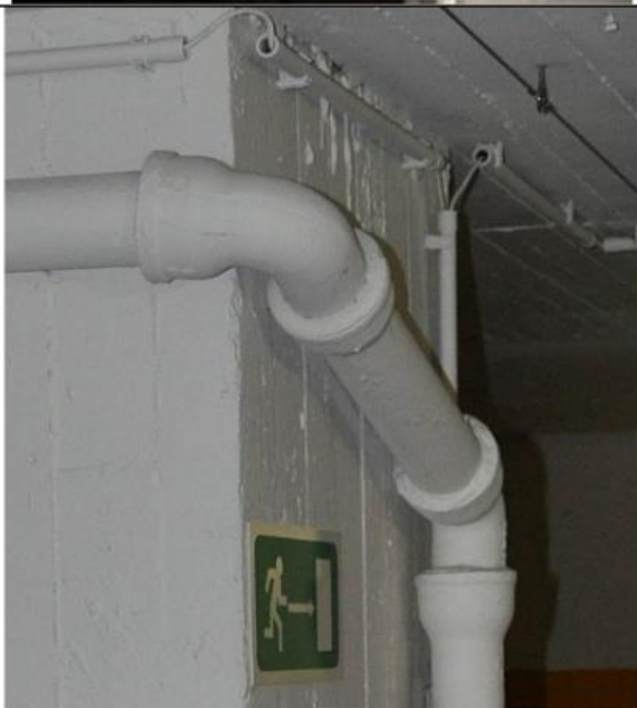
Conduites en fonte (peintes) dont les emboîtements contiennent un joint d'étanchéité plâtreux mou
